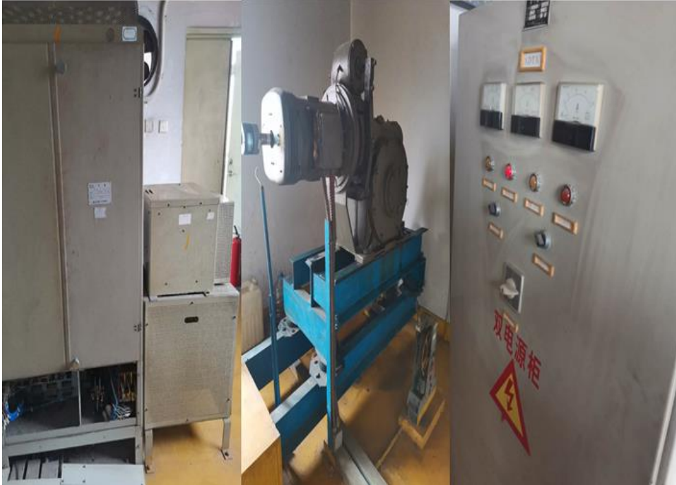
电梯设备房内设置有电源箱（配电柜），控制柜、电梯曳引机设备（具有危险性设备）。
