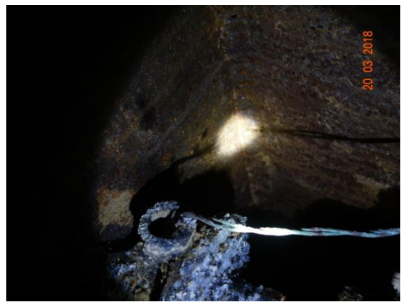
通往主仓外的照明线绝缘烧损
