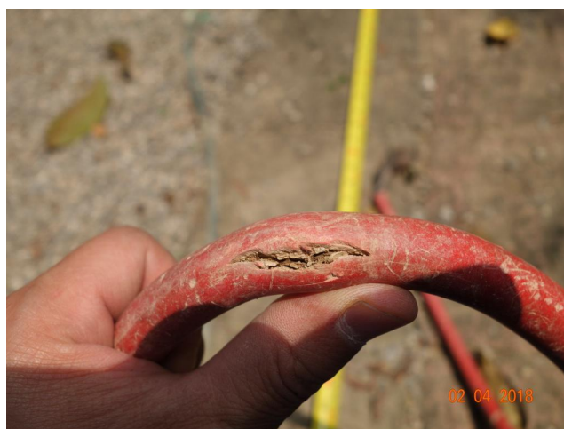
未烧损焊机电缆绝缘层受损状况
