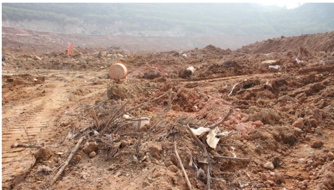
图 7 被破坏的盲沟排水设施情况图
