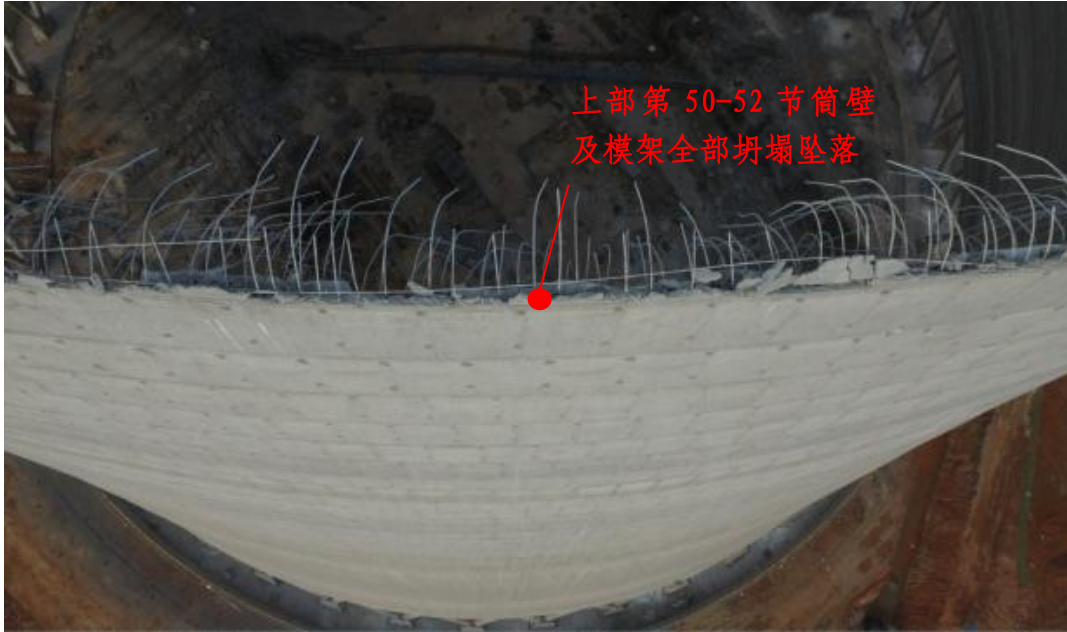
图5 第49节筒壁顶部残留钢筋
