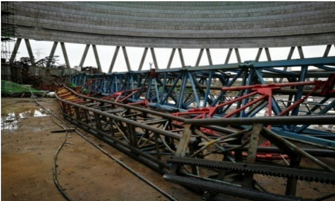
图6 事故现场坍塌平桥
